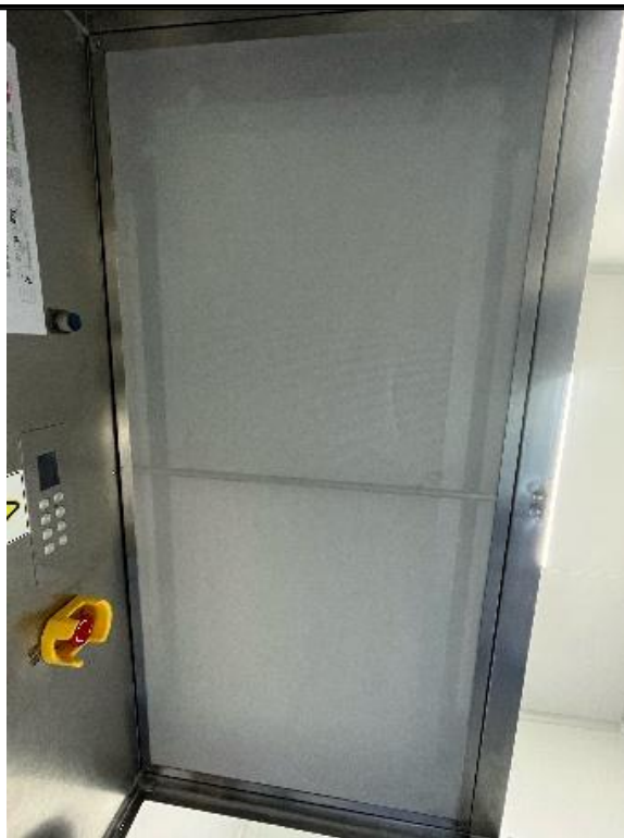
初、中、高效过滤器
