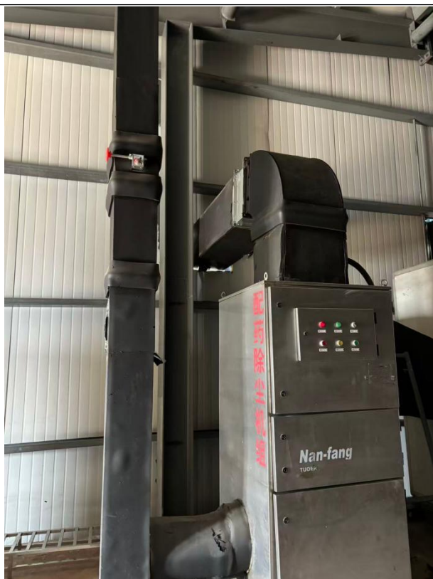
配药工序滤筒除尘器
