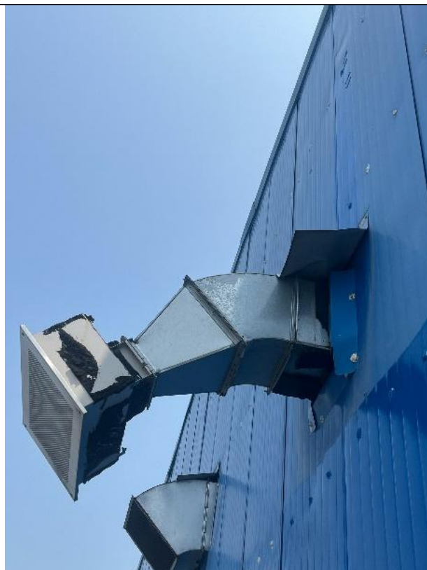
配药工序排气筒（DA002）
